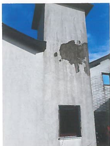
Am Bild die von der Witterung beschädigte Fassade des Schlauchturms
